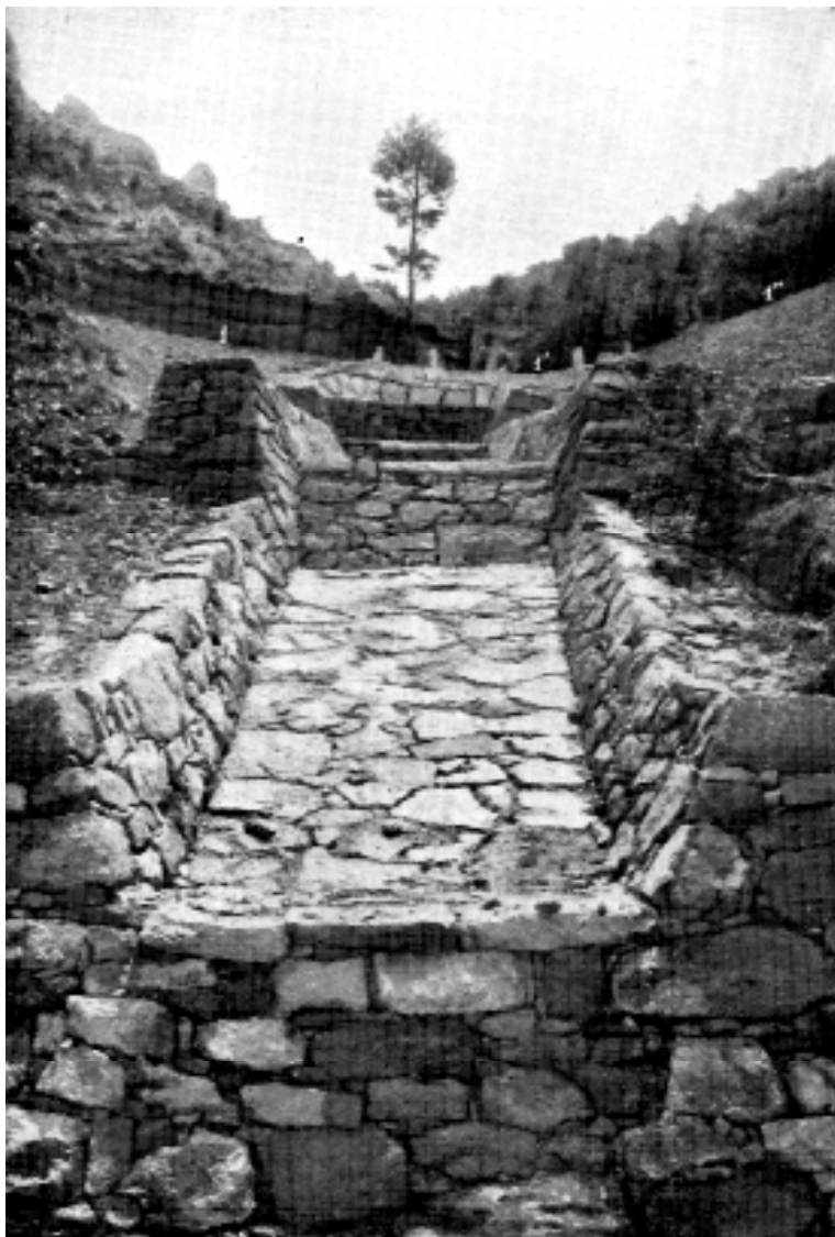
Figura 196 Las canalizaciones con pendientes muy reducidas obligan a que la lámina de agua baje con lentitud y el fondo enlosado impide que excave su cauce para recuperar la pendiente anterior. Obras efectuadas para la corrección del torrente de la Pena, en el monte de Poblet, perteneciente a la cuenca del río Francolí. Principios del siglo XX.
