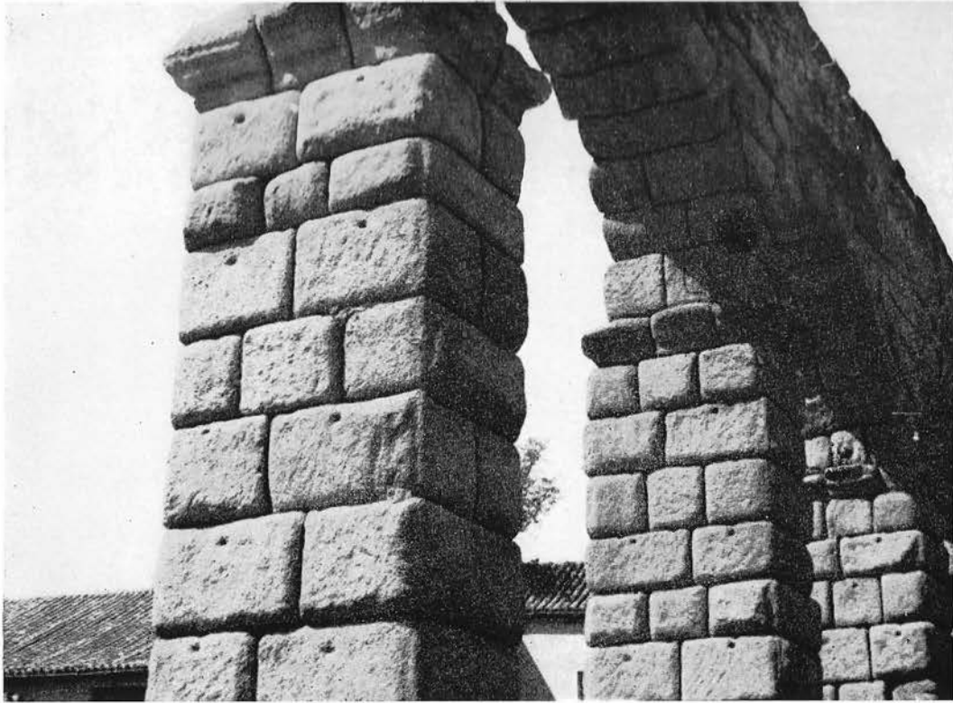
FIG. 1. — Detalle del acueducto de Segovia, mostrando la anathyrosis en los ángulos de los pilares.
