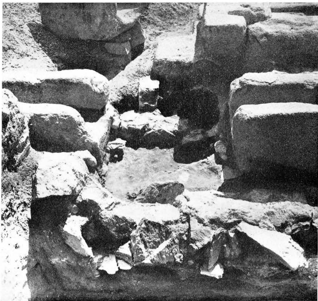
Acueducto de Segovia. — Excavación en la fuente. Una vez levantado el canal de granito, fechado en época de los Reyes Católicos, aparece bajo el otro anterior realizado con mampostería. Al fondo el conjunto de la fuente
